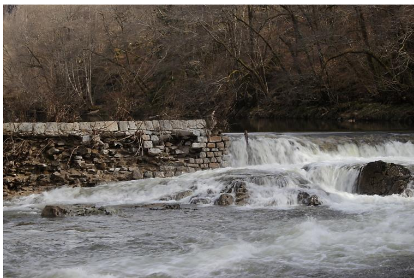
Ruines du barrage du Saut de la Saule
